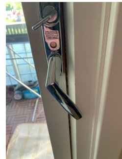
Vrideren kan virke å være feilmontert, men fungerer greit
