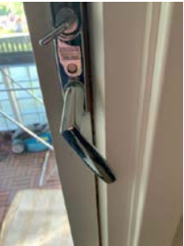
Vrideren kan virke å være feilmontert, men fungerer greit
