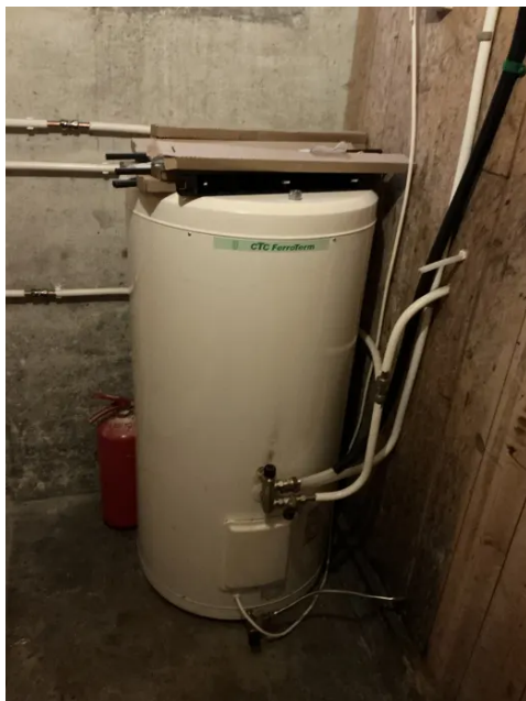
Varmtvannsbereder i kjellerbod
