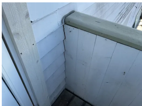
Rekkverk løst mot vegg i topp.
