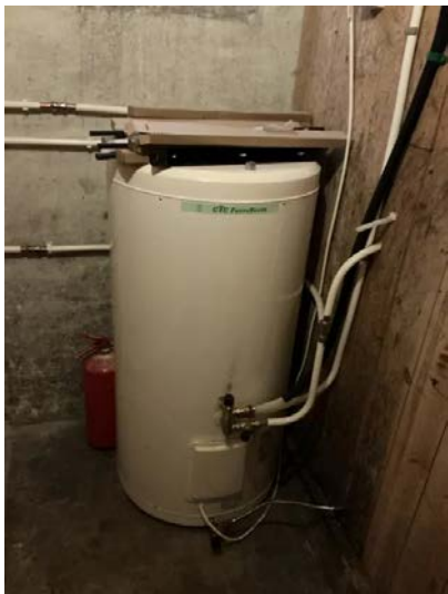
Varmtvannsbereder i kjellerbod
