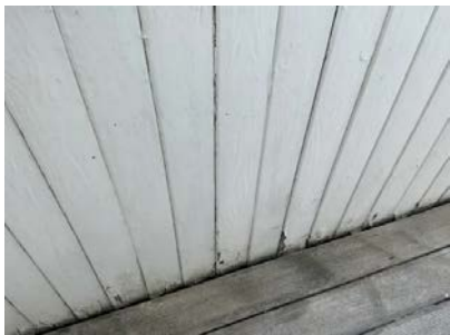
Slitasje på kledning.
