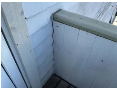
Rekkeverk løst mot vegg i topp.
