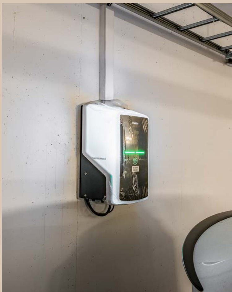
Det er montert elbil-lader på plassen.
