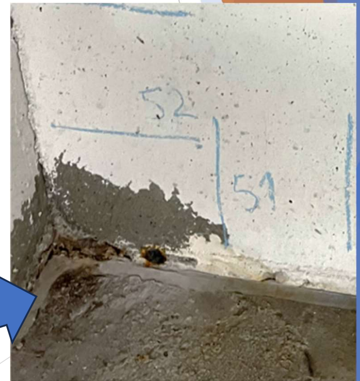
Bilde nr. 11 bildet viser spor av rustent armeringsjern i veggene.
