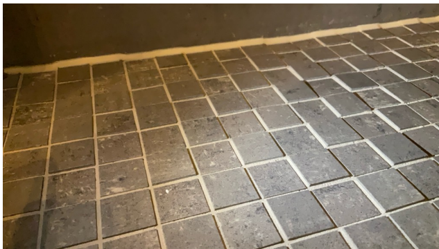
Nivåforskjeller på gulvflis i dusjen
