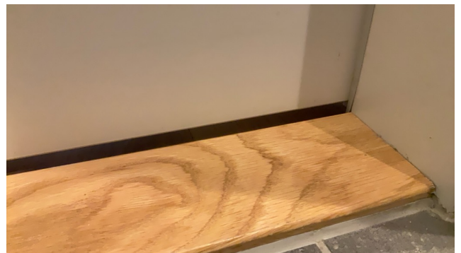
Overstrømming under døren.
