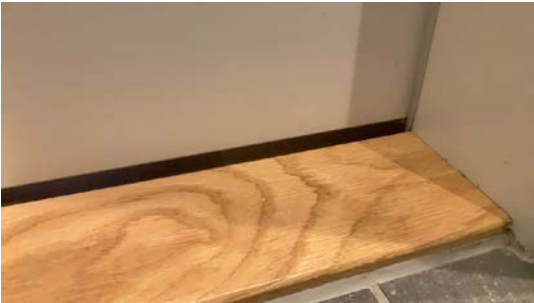
Overstrømming under døren.
