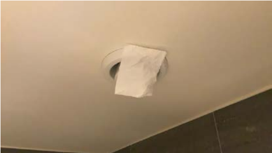
Test av avtrekk. Papiret henger.
