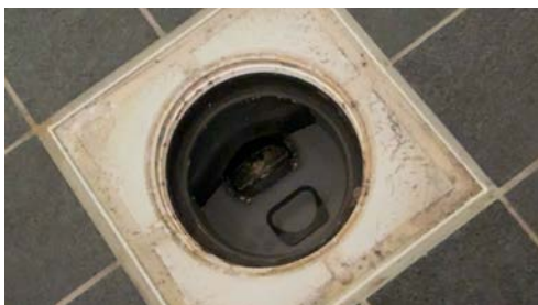
Sluk i dusjsone.
