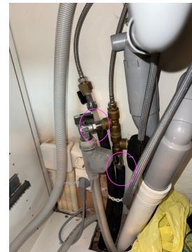
Manglende tettemuffer i benkeskapet på kjøkkenet.
