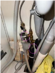
Manglende tettemuffer i benkeskapet på kjøkkenet.
