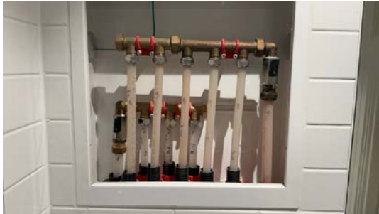
Rørskap på badet.
