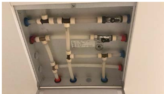
Rørskap i himling.
