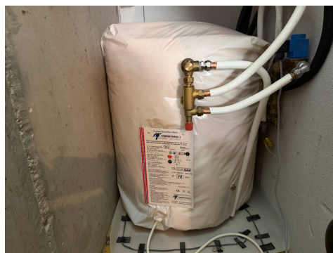
Varmtvannstank i kott.
