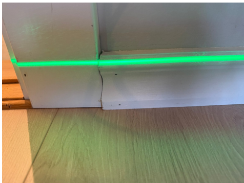
Bilder viser skjevheter i gulv i stue.
