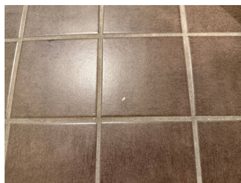
Sår i gulvflis. Må anses å være normal slitasje.
