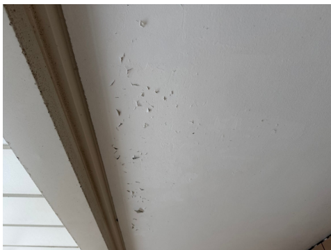
Noe malingsflass i altanhimling (Brls ansvar). Det kan indikere fuktvandring i betong.
