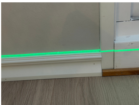
Bilder viser skjevheter i gulv i stue.
