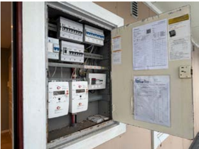
Sikringsskap i yttervegg. Utvendig adkomst.
