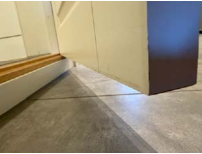
Fuktutsvelling/slitasje i nedre del av badedør.
