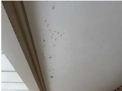
Noe malingsflass i altanhimling (Brls ansvar). Det kan indikerer fuktvandring i betong.
