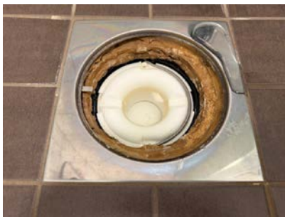
Plastsluk i dusjsone.
