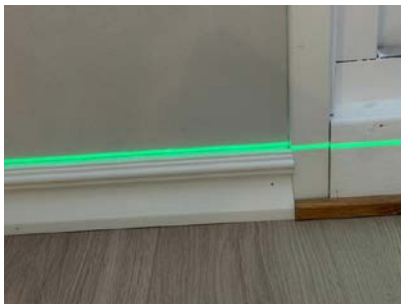
Bilder viser skjevheter i gulv i stue.
