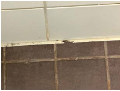
Noe misfarging i silikonfuge i dusjsone. Må anses å være normal slitasje. Silikonfuge bør refuges av fagperson v/ behov.
