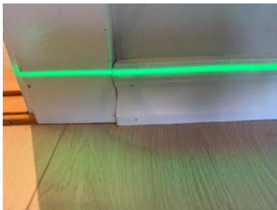
Bilder viser skjevheter i gulv i stue.
