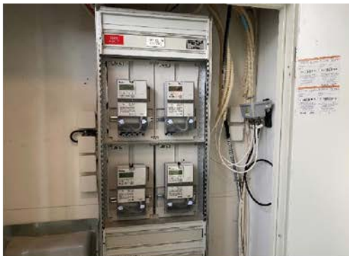
Målere i underfordelinger
