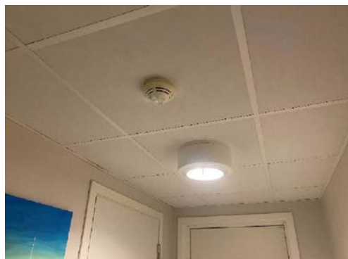
Systemhimlinger i korridorer med enkelte skader
