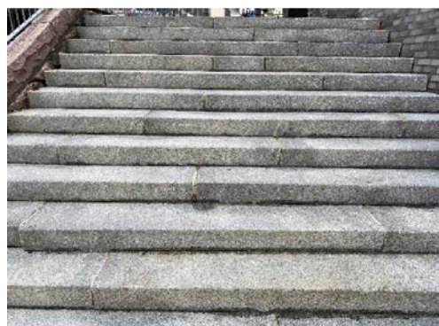
Oppsprekking i fuger
