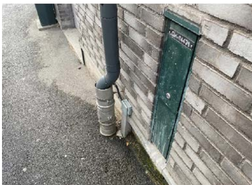
Varmekabler må kontrolleres jevnlig
