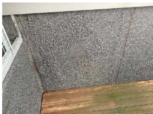
Noe varmebobling i papp
