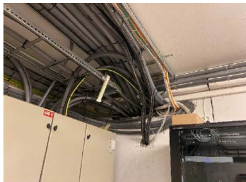
Stigeledninger i tavlerom
