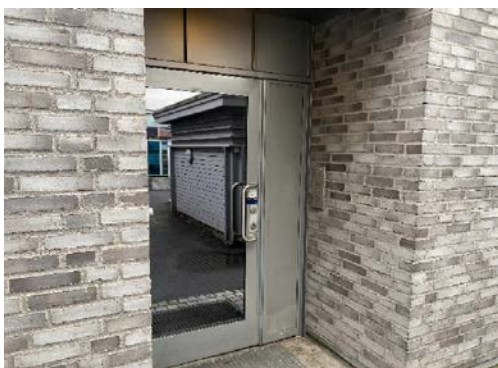
Skader bør utbedres løpende
