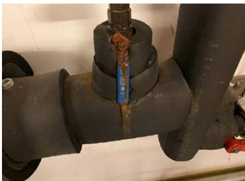
Rust på kran. Kraner må funksjonstestes regelmessig
