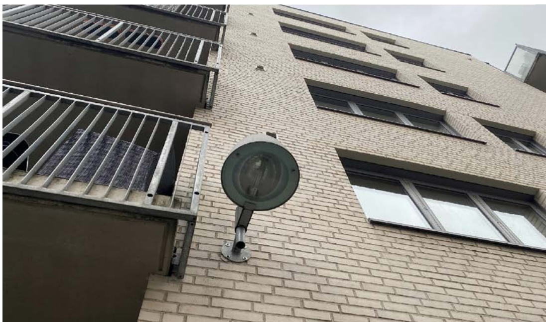
Belysningsutstyr på fasade
