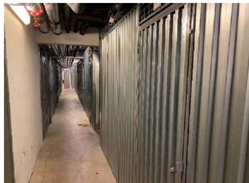
Støtskader i metallprofiler
