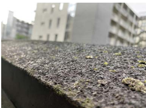
Mosegroing på avfallshus bør fjernes
