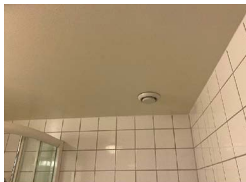
Avtrekk i våtrom
