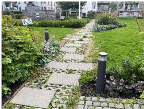
Pullertbelysning er utsatt for jordfeil
