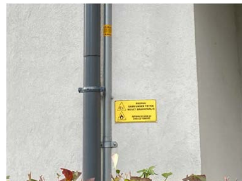
Gassrørledning på fasade
