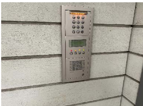
Betjeningspanel fra byggeåret
