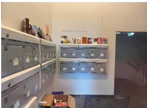
Bruksslitasje på overflater
