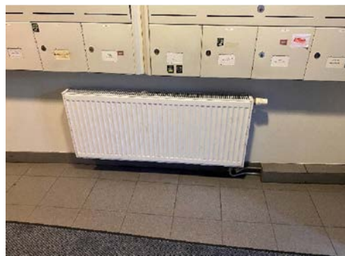
Konvektor i oppgang
