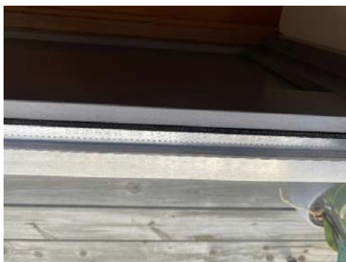
Vindu i befart leilighet er datert 2009
