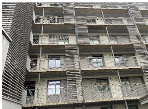
Trekledning med behov for overflatebehandling
