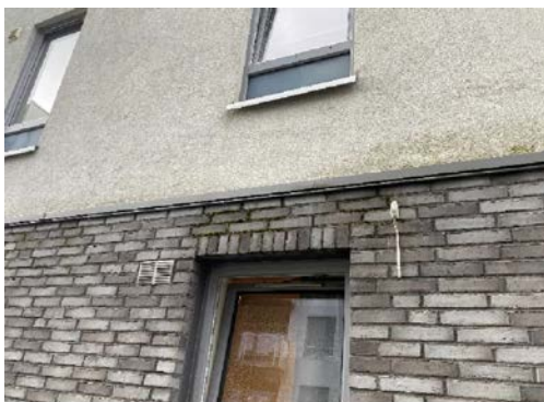
Mosegroing i fuger må fjernes.
