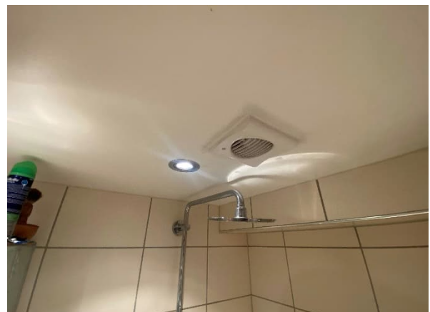
Ettermontert mekanisk avtrekk på bad
