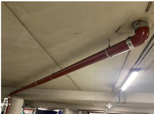
Avløp i himlinger i garasje
