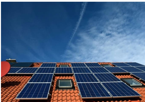
Eksempelbilde på takmontert solanlegg
