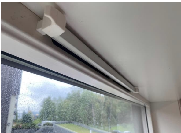
Luftinntak i vinduer
