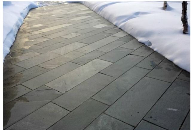
Eksempelbilde på snøsmelteanlegg utenfor oppgang
