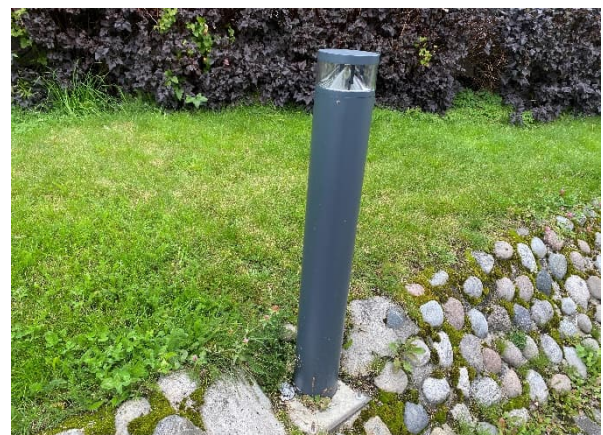
Belysningsutstyr på stolpe
