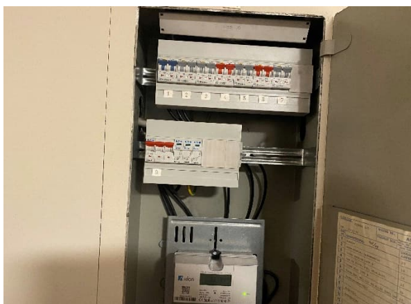
Underfordeling med automater
