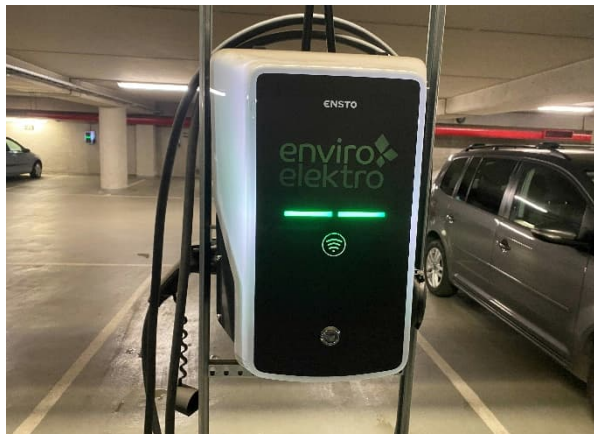
Lader i garasjeanlegg
