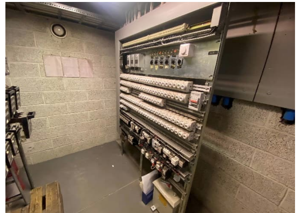
Hovedtavle med skrusikringer og berøringsfare
