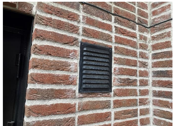
Ventilasjon i bolig
