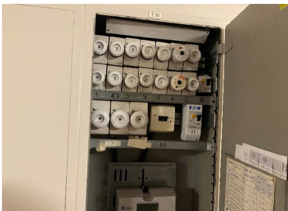
Underfordeling med skrusikringer
