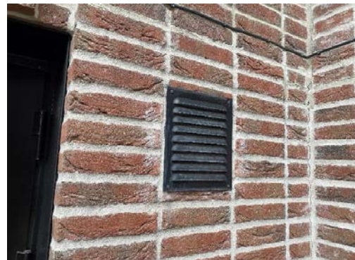
Ventilasjon i bolig
