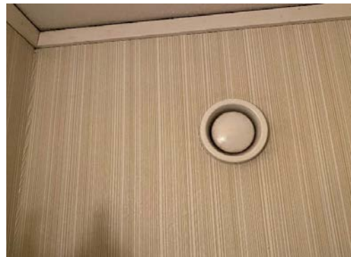
Avtreksventilasjon i bolig
