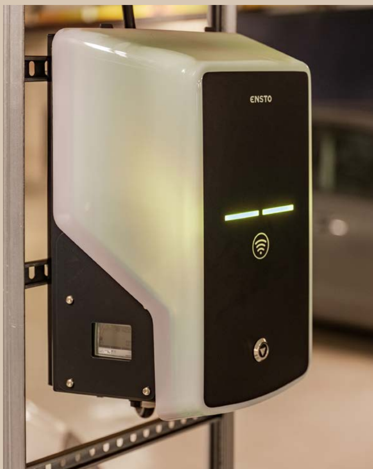
Garasjeplassen er utstyrt med elbillader.
