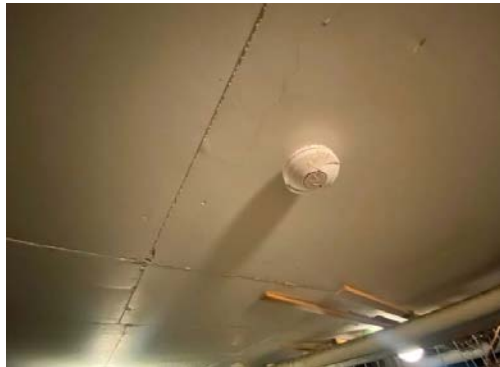
Brannvarsling i boder
