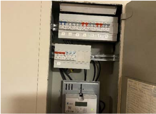
Underfordeling med automater
