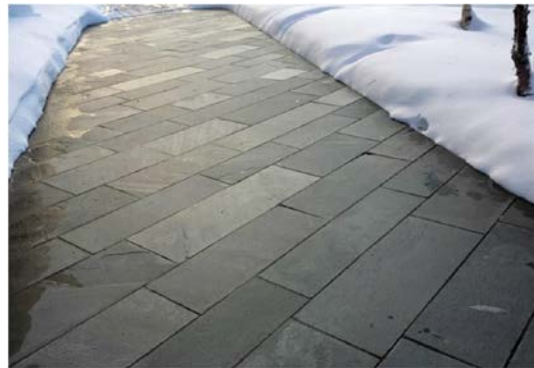
Eksempelbilde på snøsmelteanlegg utenfor oppgang
