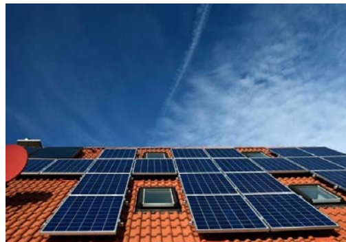
Eksempelbilde på takmontert solanlegg
