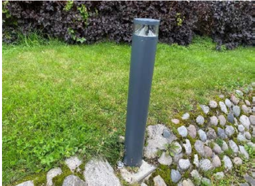
Belysningsutstyr på stolpe
