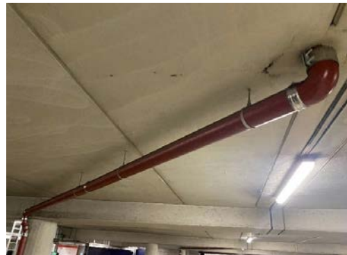
Avløp i himlinger i garasje
