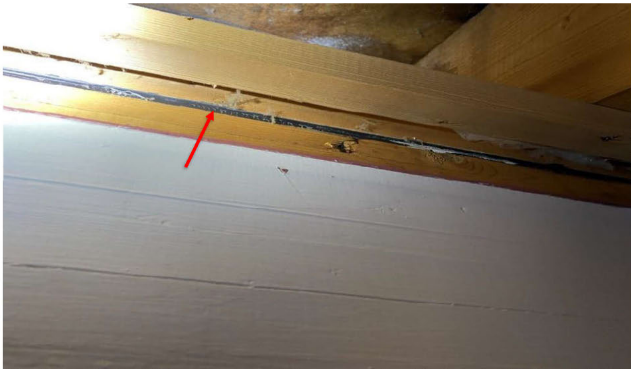
Bilde 41: Viser fugekant på drager etter at antatt dampsperre er fjernet. Dette samt at det ikke er avdekket betydelig økt skadeomfang på undertaket over dragerne indikerer at dampspærren trolig har vært relativt godt tett mot dragerne.
