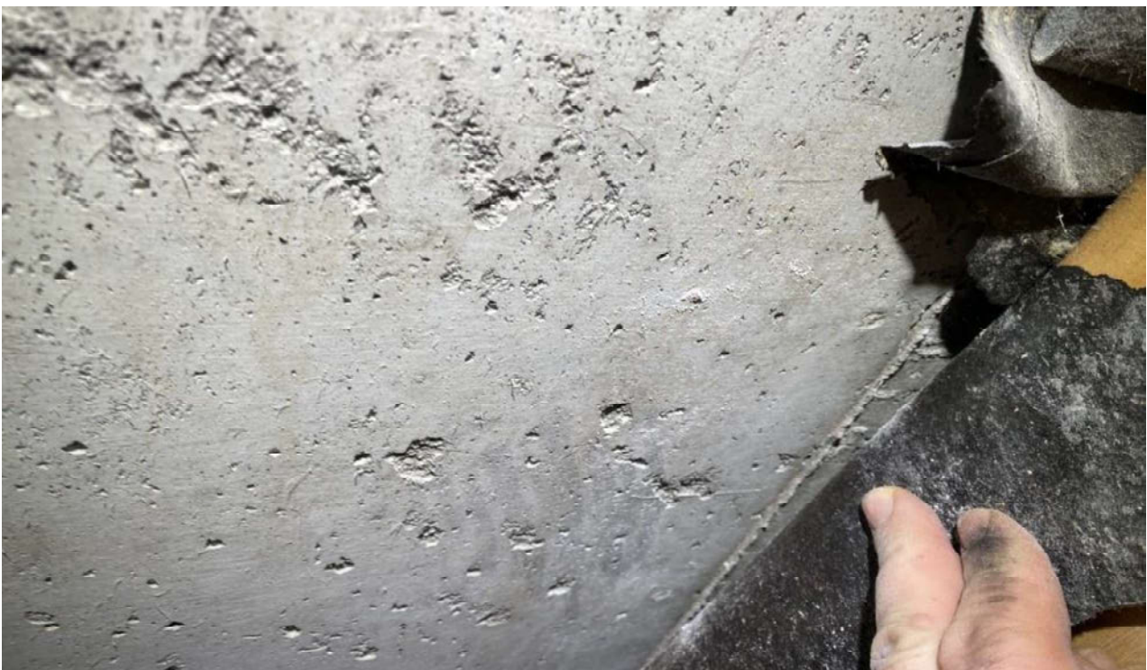
Bilde 24: Viser omtalt spalte mellom gulvstøp og grunnmur. Bildet viser også grunnmurens innside som ikke har synlige spor etter fukt/saltutslag.
