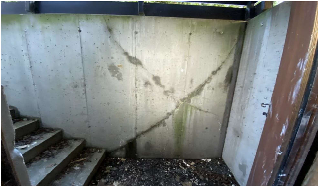
Bilde 9: Viser sprekker i betongmur ved kjellerdøren sprekke er i mur som fremstår å være støpt fast i bygget, men som ikke har laster fra det overliggende bygget. Vi mener at sannsynlig årsak til oppsprekking her er at bygget/grunnmuren har satt seg mer en betongmuren etter oppføringen.
