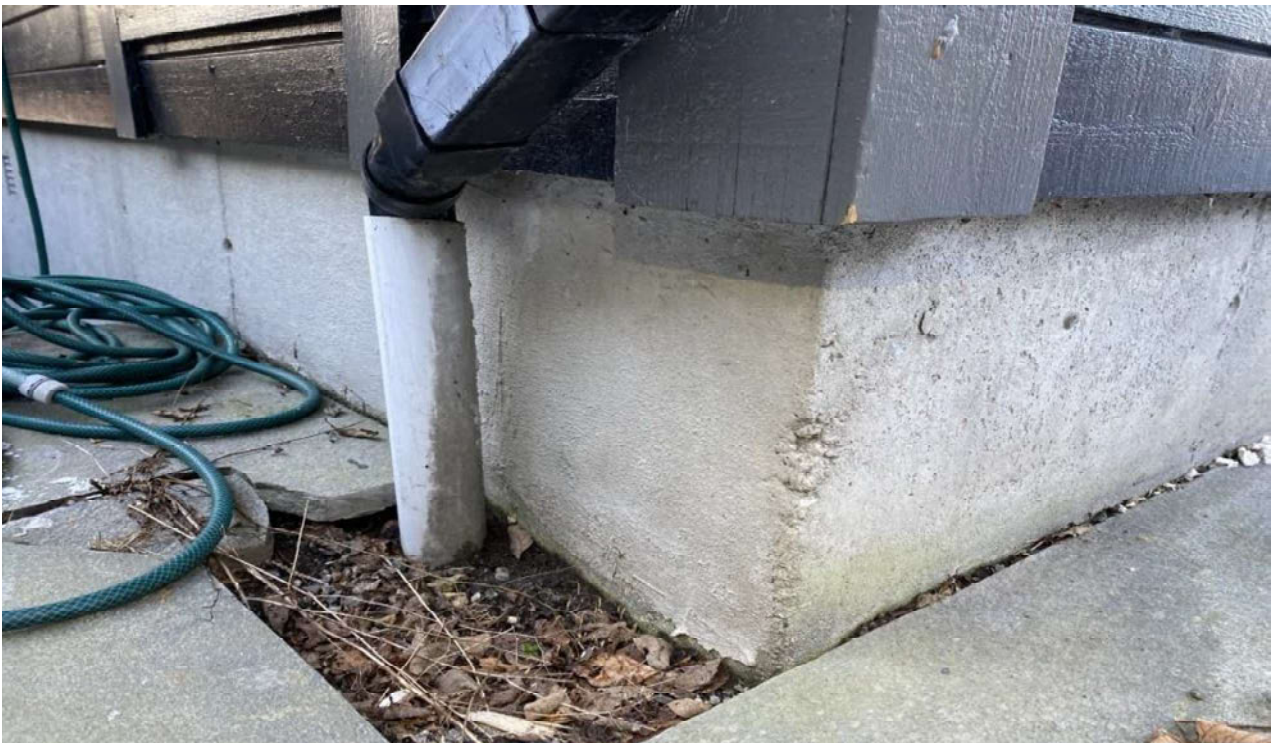
Bilde 8: Viser nærmere bilde av hjørnet. Høyere side er støpt betong antatt fra byggeår, mens venstre side avviker i overflaten da denne er påført en slemming eller tilsvarende etter byggeåret. Det antas at slemmingen er påført for å lukke/dekke til sprekken over kjellerdøren, og at det er påført helt til hjørnet fordi nyanseforskjellen skal bli minst mulig synlig.
