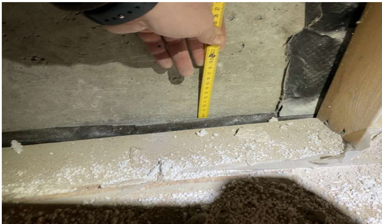
Bilde 25: Viser bilde av bunn på påforingsvegg. Meterstokken på bildet er ført ned i omtalt spalte mellom gulvstøp og grunnmur. Opptrekk av fuktig luft fra grunnen her kan gi problemer med fukt/kondensering inne i påforingsveggen.
