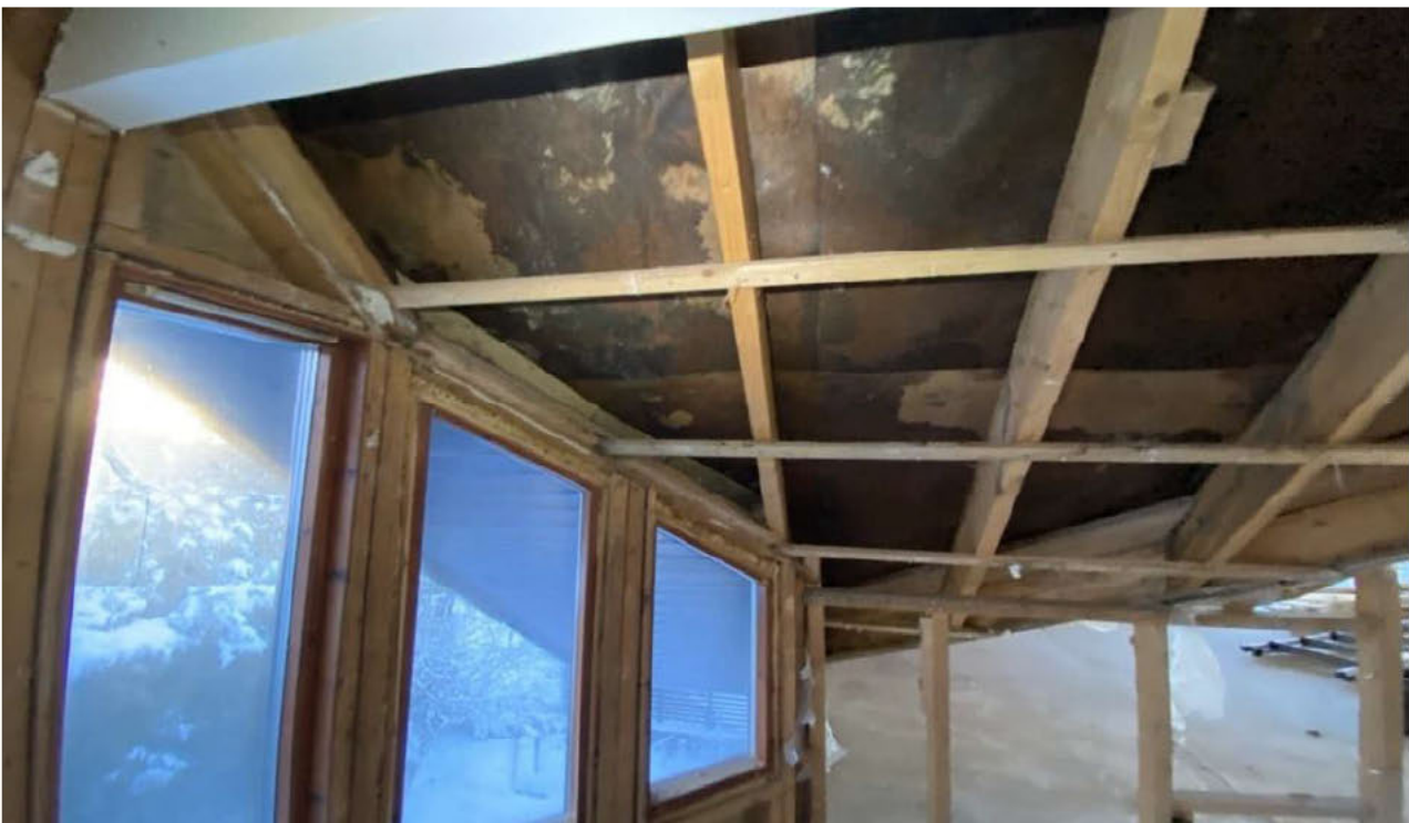
Bilde 40: Viser undertaket på sørsiden av arken. Det fremstår som at denne takflaten har betydelig inndriv.
