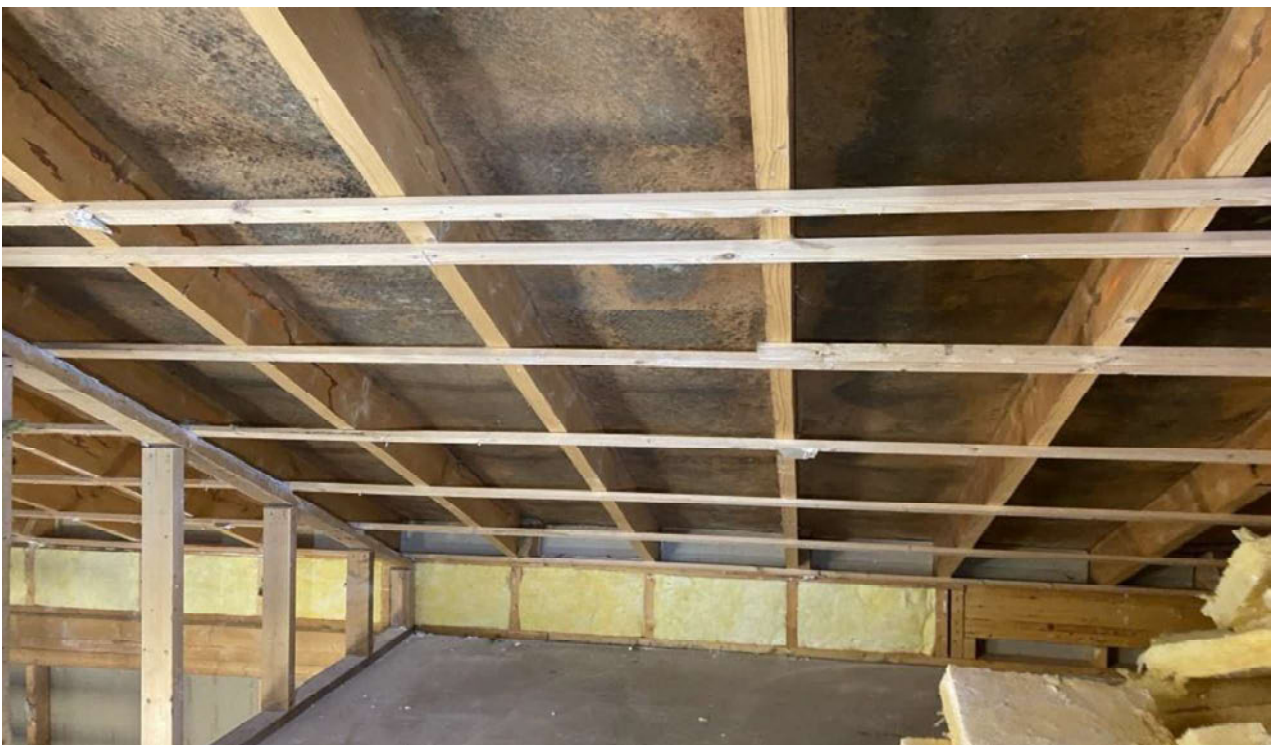
Bilde 36: Viser undertak på loft, her ser man tydelig spor etter isolasjonsplaten som har vært montert tett opp mot undertaket.
