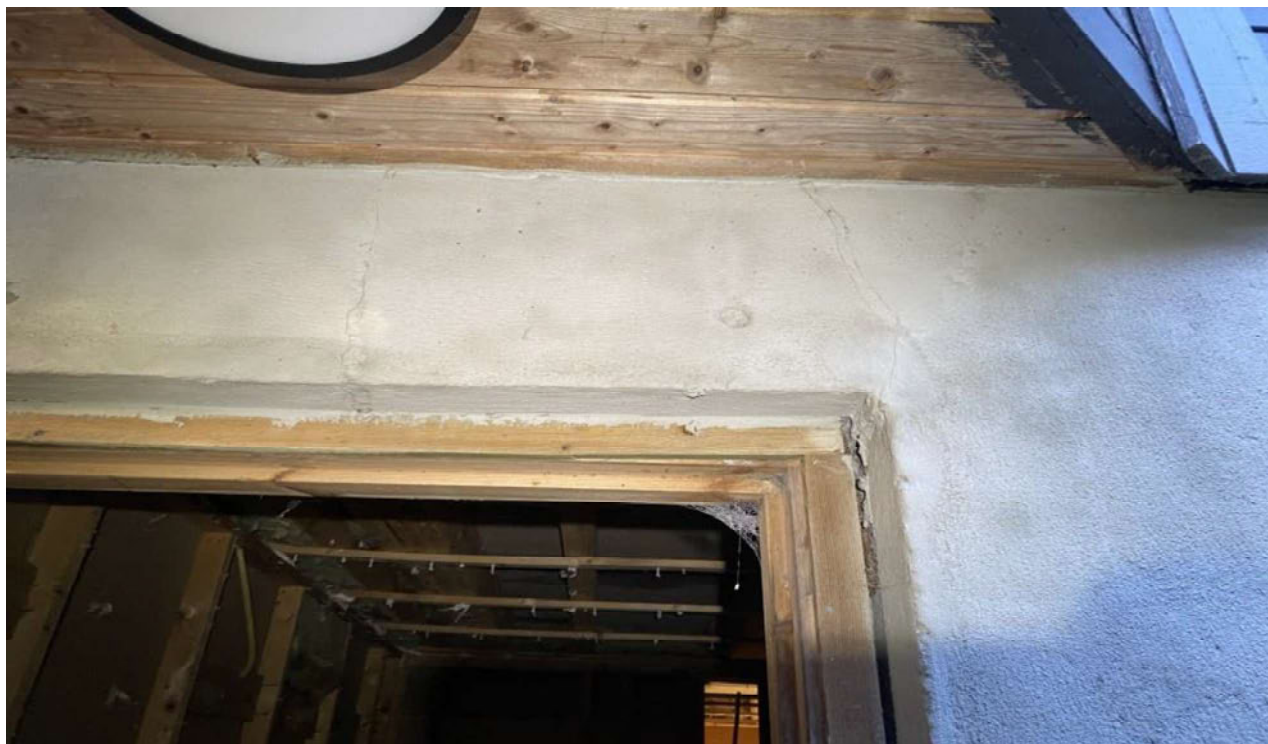
Bilde 5: Viser samme sprekk som på forrige bilde sett utenfra. Her ser man riss i muren der sprekken tidligere var, noe som er påregnelig dersom denne kun dekkes over uten at man armerer overgangen.
