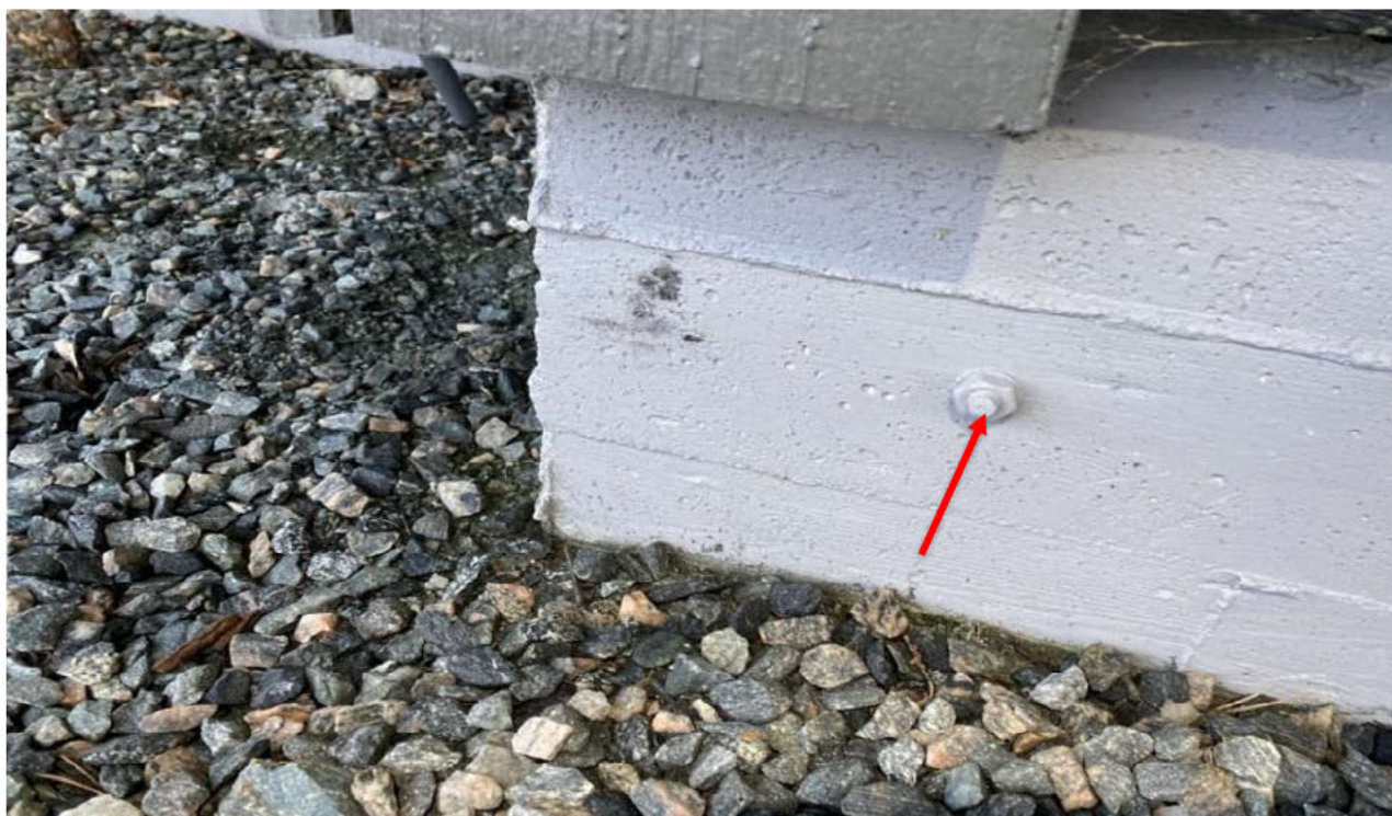
Bilde 20: Viser omtalt bolt som er avdekket i grunnmuren. Bolter i grunnmuren kan indikere at det er utført bevegelsesmålinger på eiendommen tidligere, men normalt sett vil man da finne flere bolter i grunnmuren, noe som ikke er avdekket på denne boligen.
