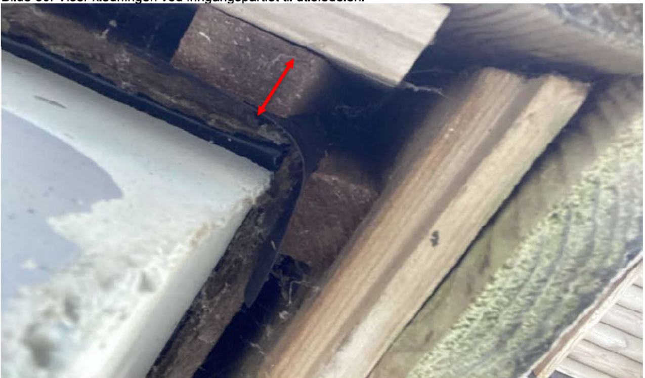
Bilde 30: Viser bilde tatt opp under kledningen på utleiedelen. Her fremstår det som at kledningens luftelekter her større dimensjon (ser it som 22x48 lekter, men lektene er ikke kontrollmålt av undertegnede).
