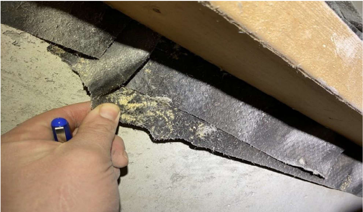
Bilde 23: Viser mugg/soppvekst på baksiden av pappsjikt/vindsperre.
