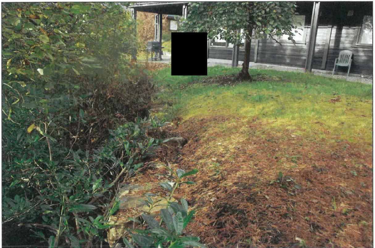
Figur 1-13. Muren i ytterkant av plenen (figur 1-11) viser sig og plenen mangler støtte mot sig.
