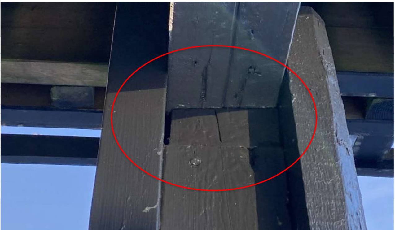
Bilde 16: Viser at søylen under terrassene er forlenget med kloss. Dette er tilfellet på alle de kontrollerte søylene under terrassen. At det er en slik utførelse indikerer at det er forsøkt å rette opp terrassen etter at grunnen har satt seg.
