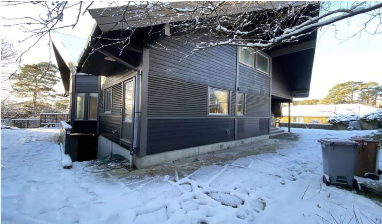
Bilde 7: Viser oversiktsbilde. Grunnmuren er overflatebehandlet fra under karnappet til venstre i bildet og hele veien frem til hjørnet.
