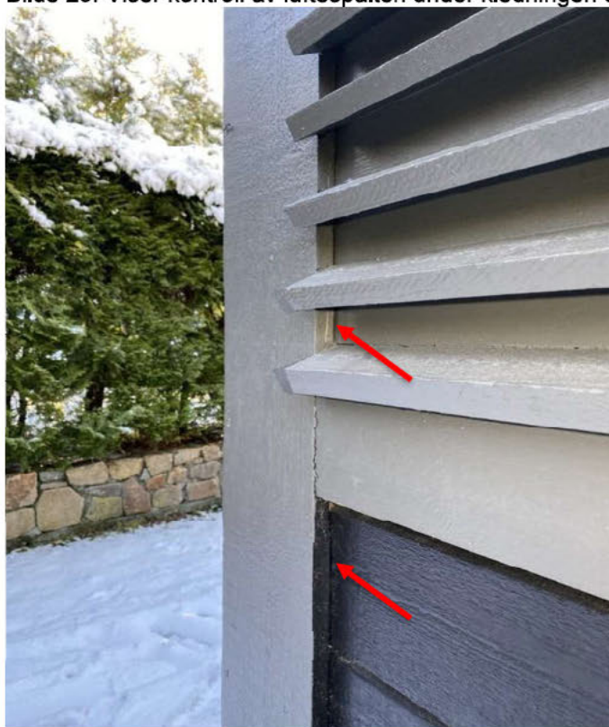
Bilde 30: Viser detalj av kledning der det er felter med svikende kledningsmønster. Bildet viser at kledningen her fremstår å ha samme avstand til hjørnebordet. Det antas derfor at luftingen i veggen er ført bak disse feltene også.
