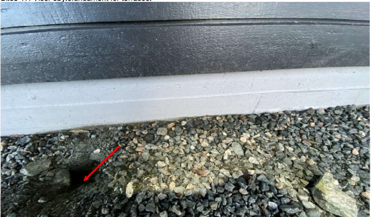
Bilde 18: Viser såkalt synkehull i front av boligen. Det er kun fremvist et slikt hull på befaringsdagen.
