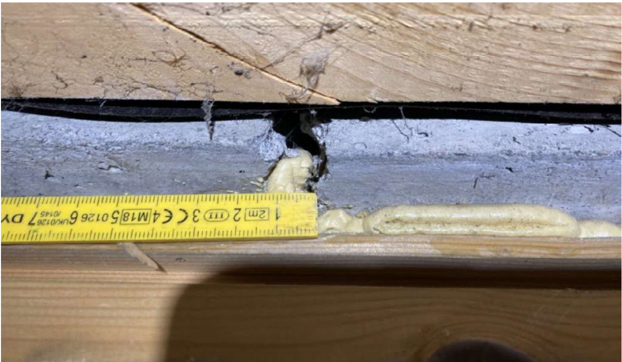
Bilde 4: Viser sprekk over kjellerdør sett fra innsiden etter at påføringsvegg og eventuelle lister er revet fra døren.
