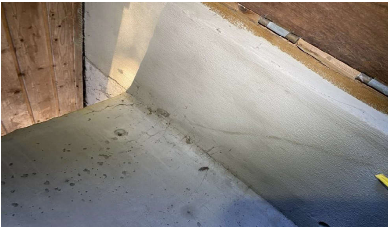
Bilde 10: Viser grunnmur og betongmur der de møtes. Her er det sprekke/riss både i grunnmuren og i betongmuren, noe som indikerer på bevegelse/spenninger etter støping/oppføring.
