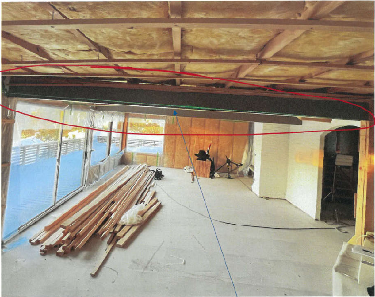
Laser på dragers underkant. kontroll om hadde horisontal avvik. Nullpunkt på dragers underkant til høyre i bilde. Mens laserwater er noen cm opp på drager som har sig på venstre side av drageren.
