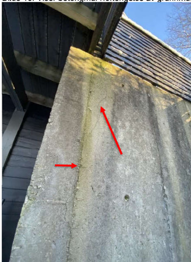
Bilde 14: Viser sprekk/riss i antatt støpeskjøt, samt diagonalriss i øvre del av muren som trolig er forårsaket av at murene har hatt differensiell setning etter oppføring.
