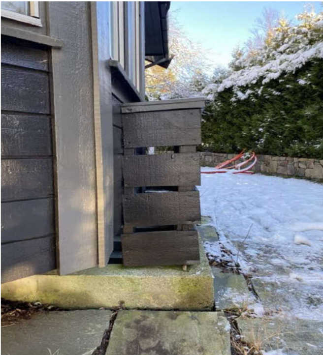
Bilde 11: Viser rekkverk oppå betongmur som trolig har blitt bygget i vater inn mot karnappet. I dag skrår rekkverket ned mot karnappet, dette trolig som følge av setninger i karnapp/boligen som er større en de naturlige setningene som betongmuren antas å ha hatt.
