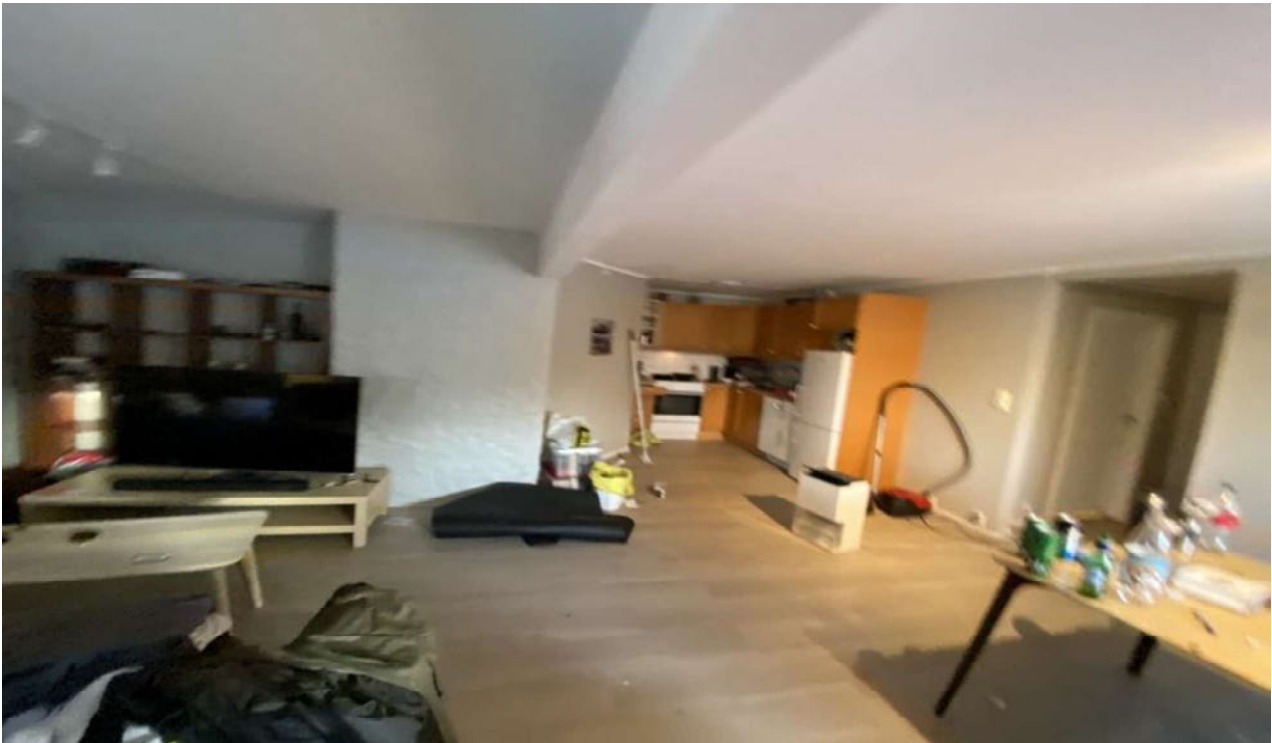
Bilde 21: Viser bilde tatt inne i leiligheten på befaringsdagen. Her er det også registrert en del skjevheter ut mot grunn/ringmurene, med noe avtakende skjevheter på midten av gulvet. Årsaken til dette vurderes å være at dette gulvet hviler på grunnen unedr boligen og ikke på bjelkelag som igjen ligger ned på grunnmurene til boligen.
