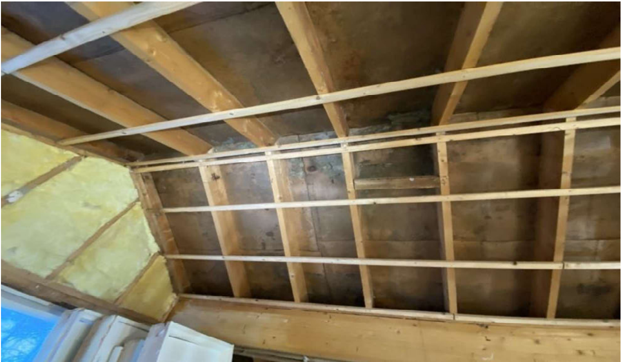
Bilde 37: Viser undertaket opp mot mønet. I mønet fremstår det som at det tidvis driver inn vann, da missfargingen her er større enn ellers i takflaten.
