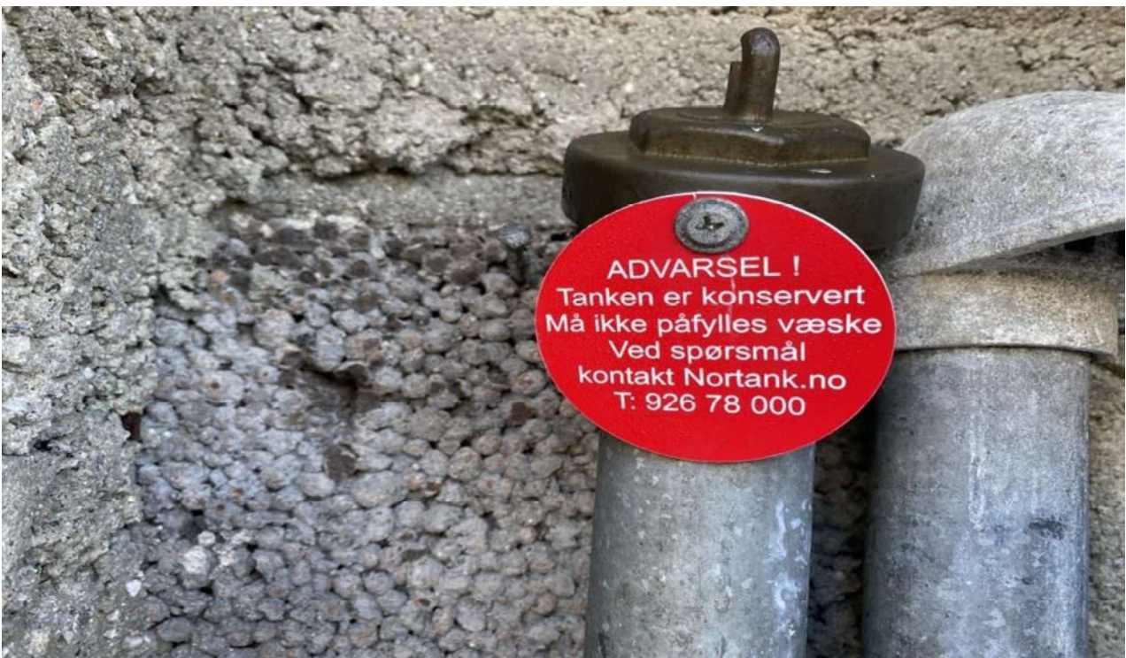
Bilde 45: Viser skilt som er påmontert påfyllingsrørene.
