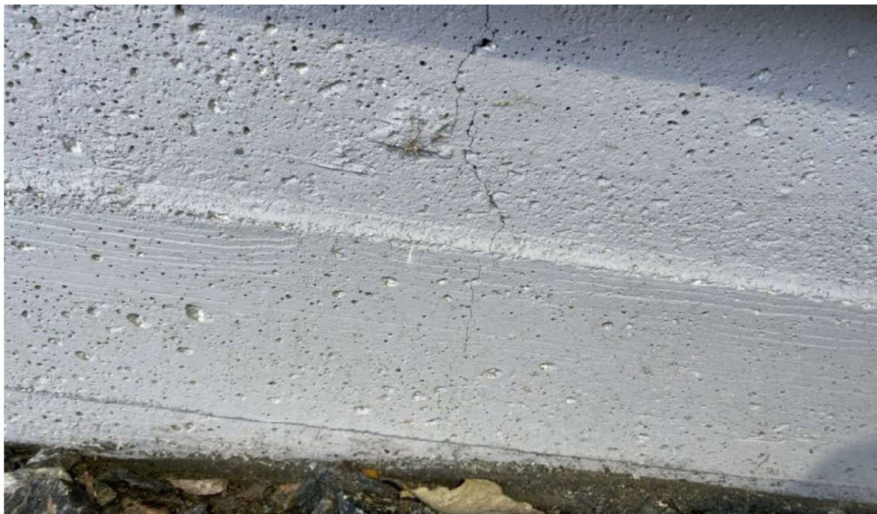
Bilde 19: Viser riss i ringmur, samt at ringmur er malt overflatebehandlet over terrenget på dette punktet.
