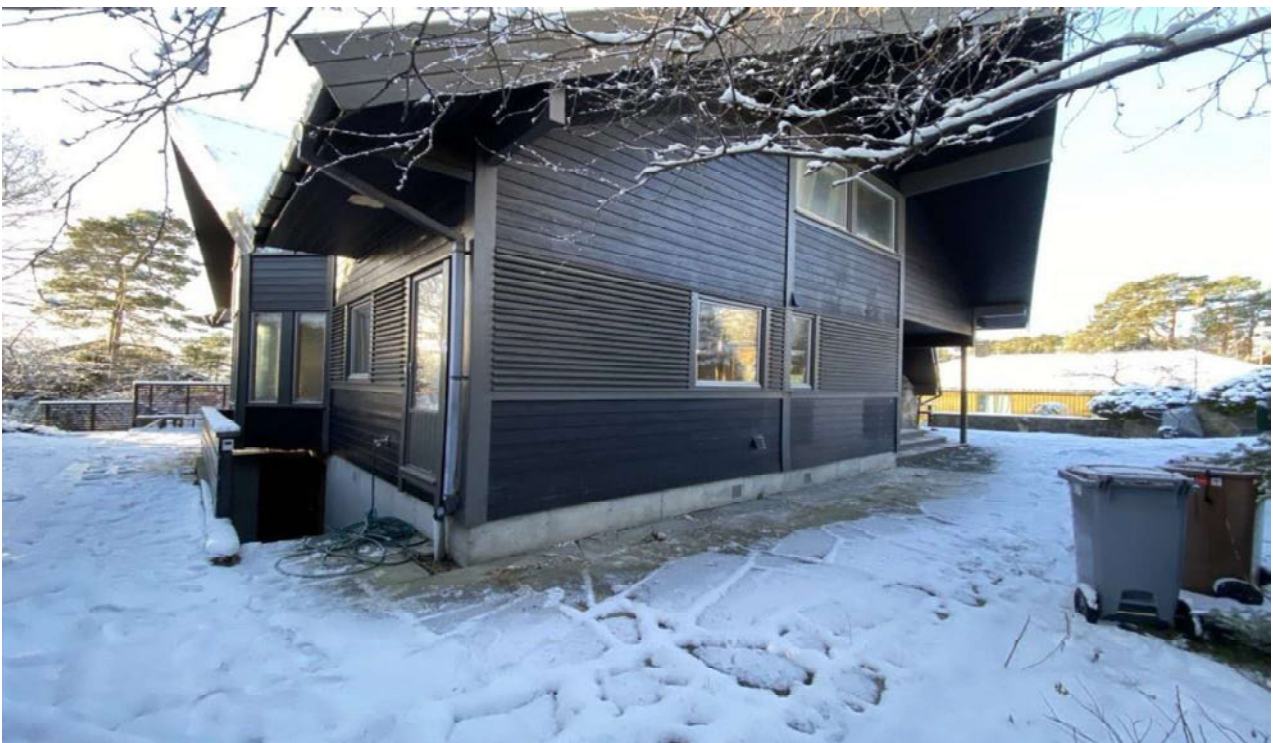
Bilde 28: Viser oversiktsbilde utvendig. Bildet viser at det ikke er synlig knotteplast utvendig over terrenget. Bildet viser også byggets trekledning.
