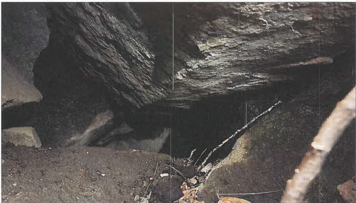
Figur 3: Et bilde som viser situasjonen til løsmasser i noen av hulene mellom steiner og blokker som dekker fyllingen. Kilde: Sweco Norge AS.
