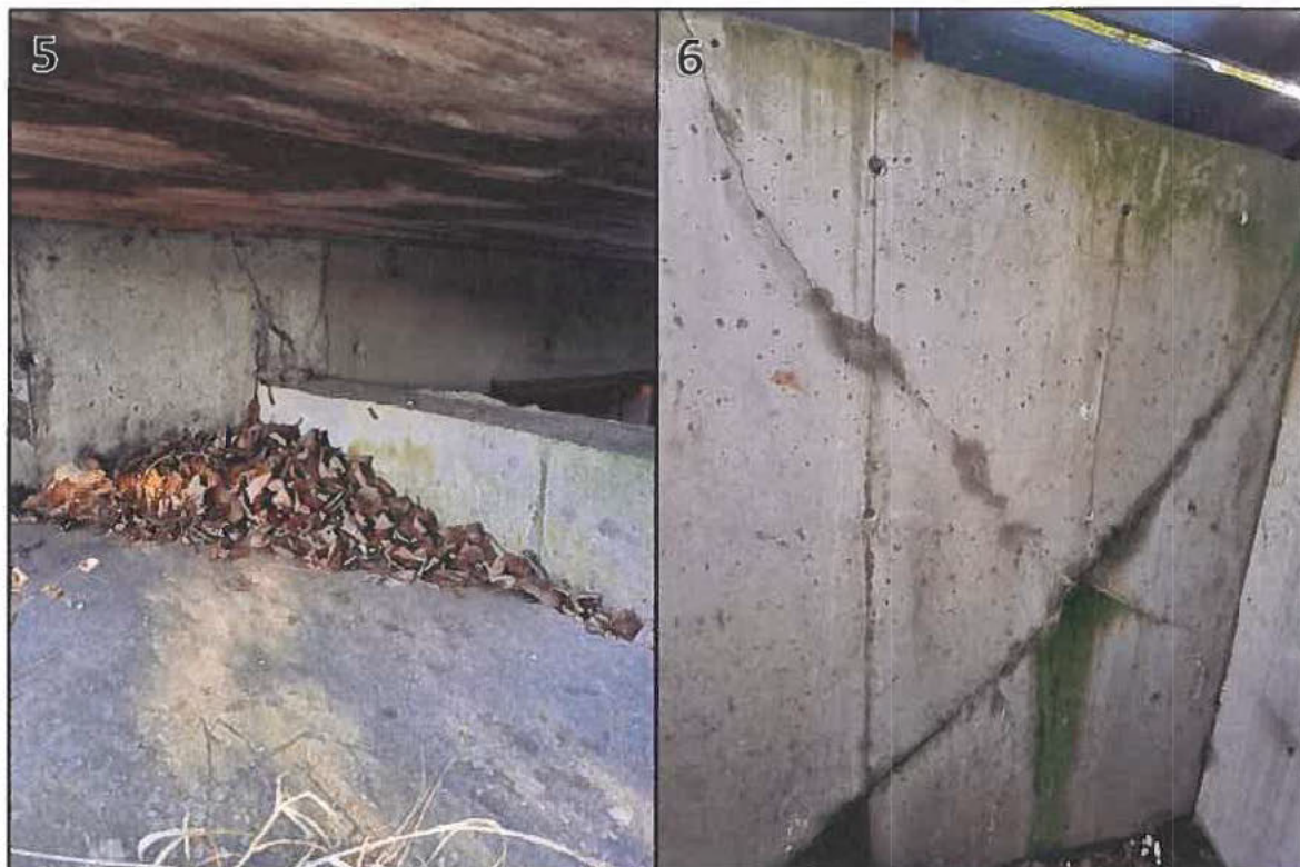
Figur 3-4 Sprekker over kjellerdør (5) og betongvegg ved trappene (6).
