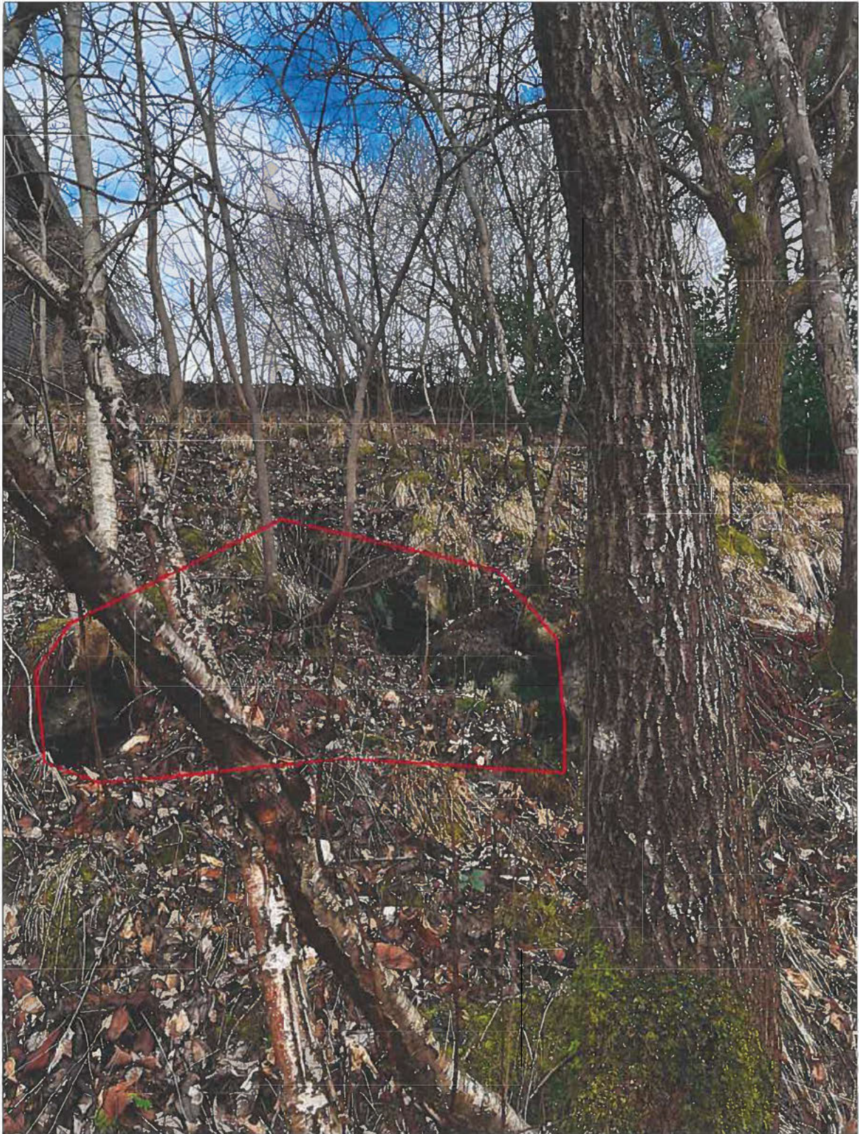
Figur 5: Sannsynlige tegn på setninger på dekkelet til fyllingen er vist med rød polygon. Kilde: Sweco Norge AS.
