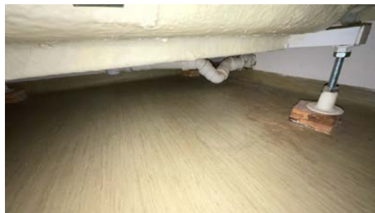
Avløp til dusjkabinett går ut til kjøkkenet.
