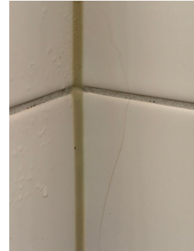
Sprekker i 3 veggfliser i hjørne, dusj.
