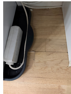
Det bemerkes svellemerke i parkett ved balkongdør og ved kjøleskap.
