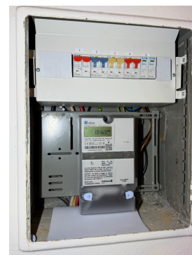
Automatsikringer med skap i felles korridor.
