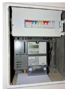
Automatsikringer med skap i felles korridor.
