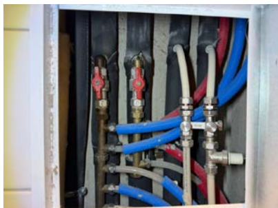
Samlestokk i innkassing på bad med 2 x stoppekraner.
