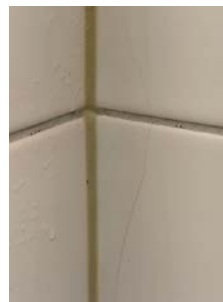
Sprekker i 3 veggfliser i hjørne, dusj.
