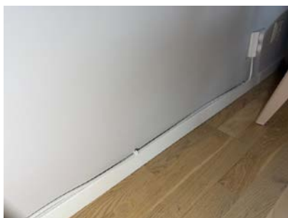
For langt mellom klamringer på ledninger i stue
