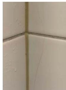
Sprekker i 3 veggfliser i hjørne, dusj.
