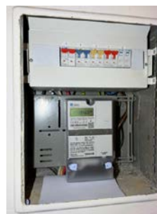
Automatsikringer med skap i felles korridor.
