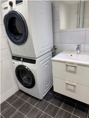
Sluk på bad i U.etasje
