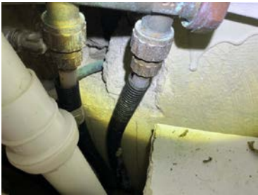
Ikke tilfredsstillende rørføring gjennom vegg under servantskap.
