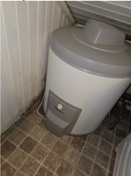
TG 3 7.1.2 Overflate gulv
