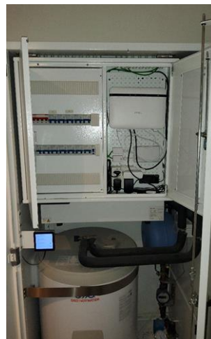
Elektrisk anlegg - [Sikringsskap ]
