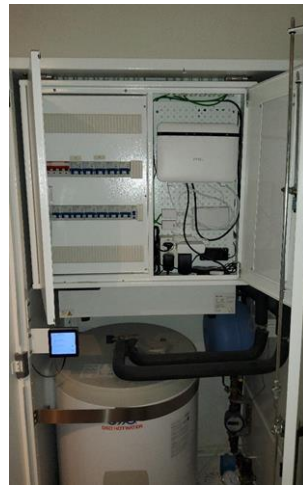
Elektrisk anlegg - [Sikringskap ]
