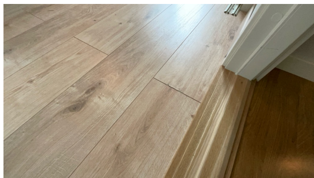
Avvik på gulv.
