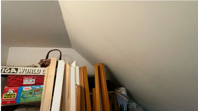
Stedvis synlige avvik.
