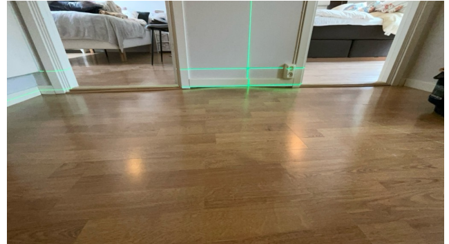
Synlige avvik på etasjeskillen i 2.etg.
