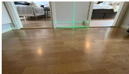
Synlige avvik på etasjeskille i 2.etg.
