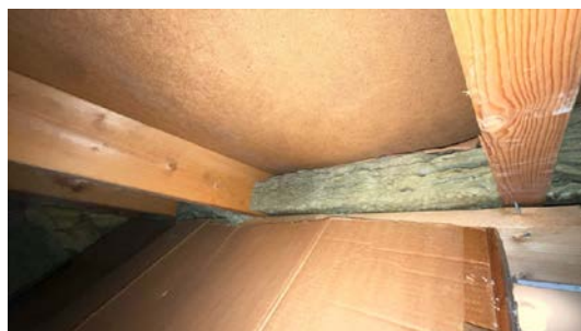
Minimalt med luftespalter på isolert del.
