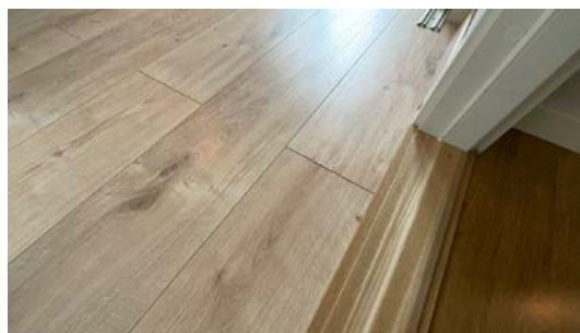
Avvik på gulv.
