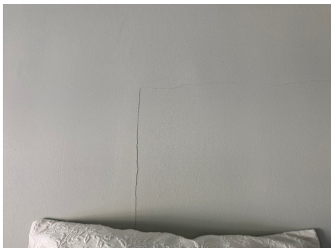
Sprekk/riss i vegg.
