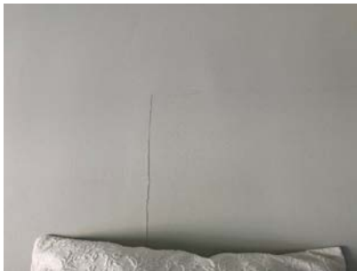
Sprekk/riss i vegg.
