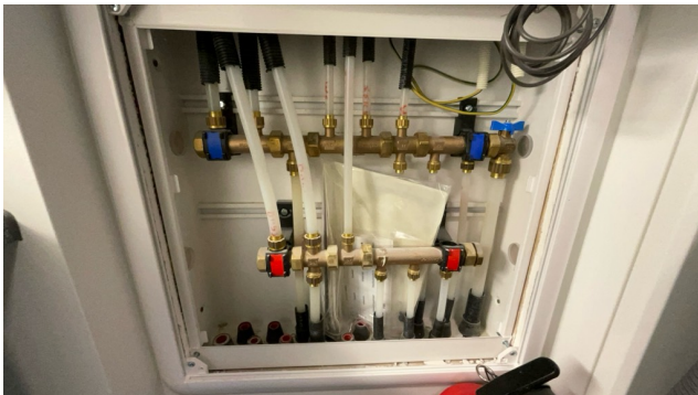
Rør er merket på pexrøret, men klistrelapper som ligger i skapet bør settes på hvert enkelt vannrør.
