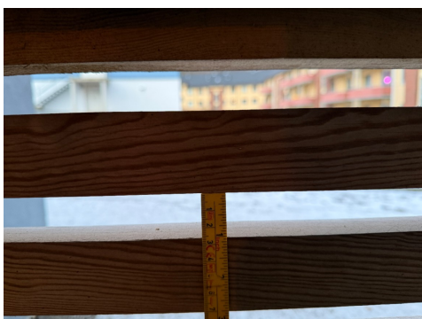
Åpninger mellom trespiler er større enn 2 cm. Rekkverk skal utformes slik at klatring forhindres. Avvik registrert under HMS-punkt.
