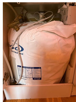
Varmtvannstank i kjøkkenskap.
