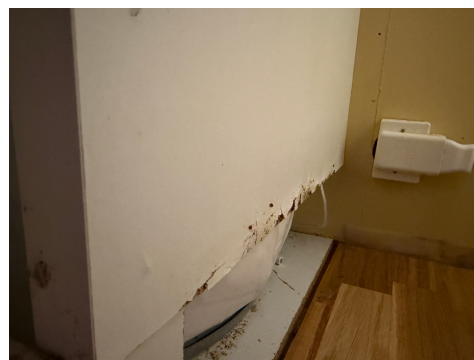
Fuktutsvelling på skapstamme v/ komfyr plass.
