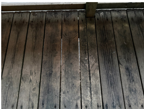
Værøppsprukket trevirke på terrassebord.
