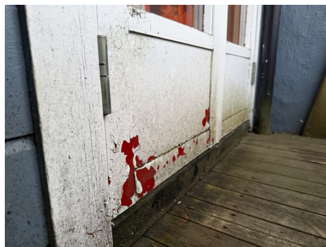
Malingsflass på utside av altandør.
