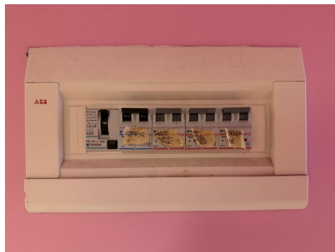
Sikringsskap i stue/kjøkken.
