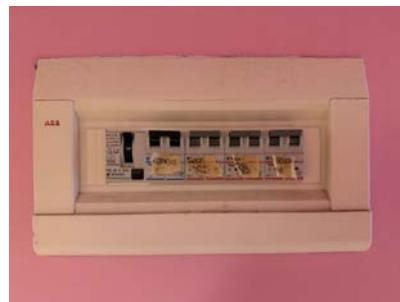
Sikringsskap i stue/kjøkken.
