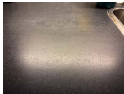
Slitasje i benkeplate.
