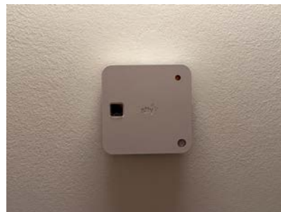
Sfty-røykvarslar i entre/gang.
