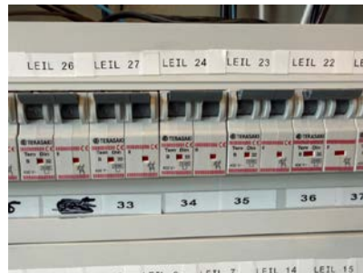
Hovedsikring i felles sikringsskap, merket nr 24.
