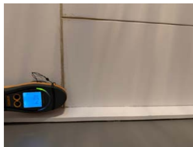
Fuktmerker på takplater på soverom. Ingen forhøyede fuktverdier ble registrert i det aktuelle område på befaringsdagen.
