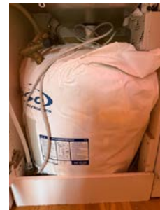
Varmtvannstank i kjøkkenskap.
