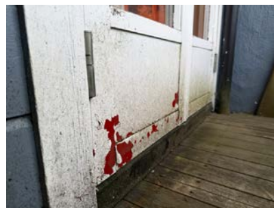
Malingsflass på utside av altandør.
