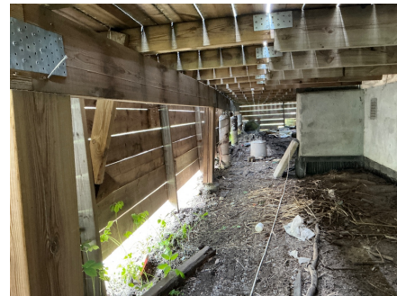
Skjevhet i konstruksjon
