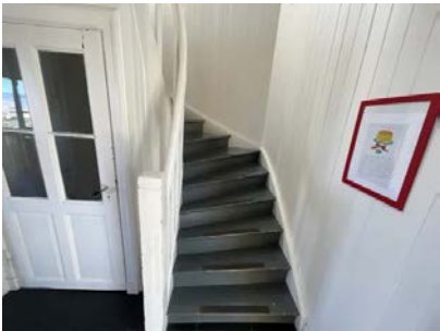
Synlig slitasje i trinn og håndløper
