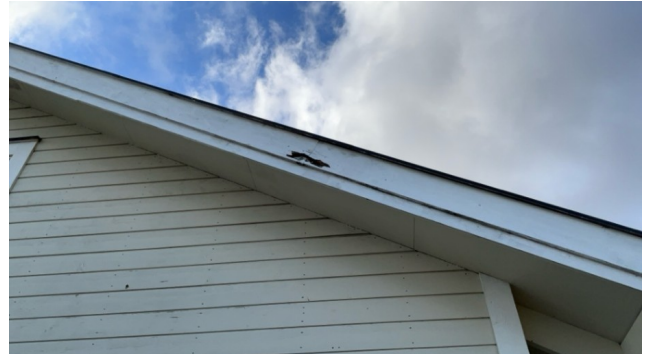
Synlig elde og skader.
