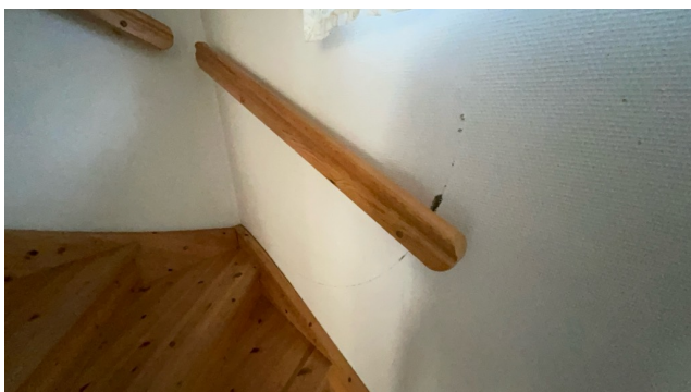
Håndløper må utbedres.
