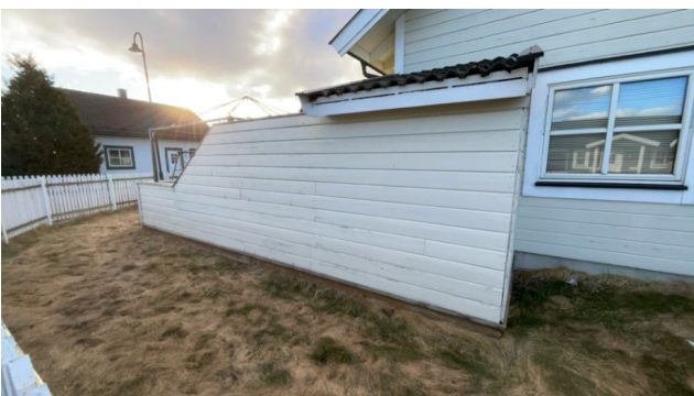
Synlig elde og skader.
