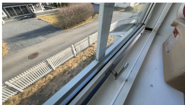
Synlige skader der vindu ikke lar seg lukket fullstendig.
