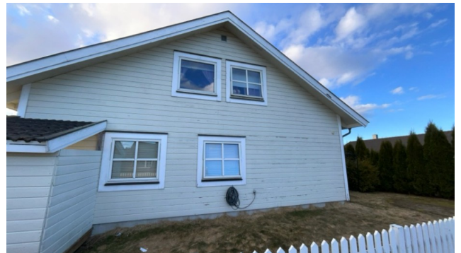
Synlig elde og skader.
