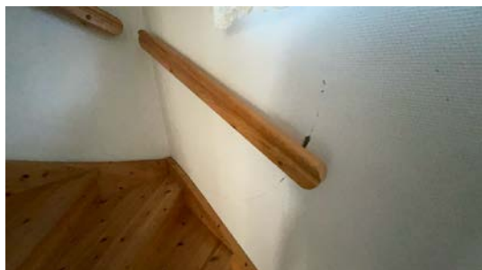
Håndløper må utbedres.
