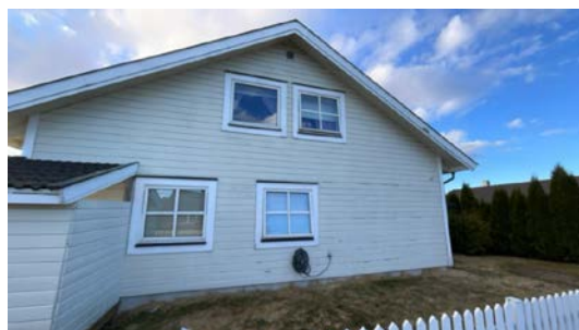
Synlig elde og skader.
