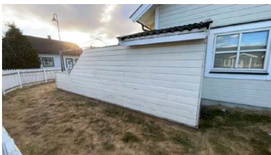
Synlig elde og skader.
