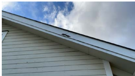
Synlig elde og skader.
