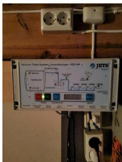
Annet - Kontrollpanel for toalett
