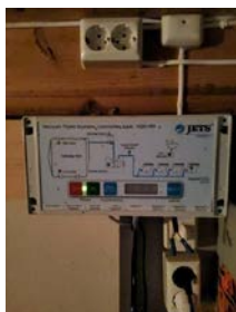
Annet - Kontrollpanel for toalett
