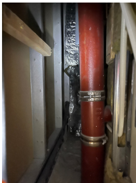
Rørsjakt med avløpsrør av støpejern bak inspeksjonsluke fra stue.
