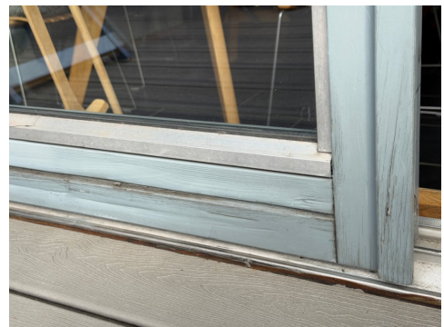
Vårslitt utvendige dører - sprekk i bunnstokk på bilde.
