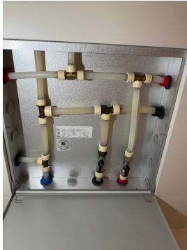
Rørskap i baderomshimling med 2 x stoppekraner.
