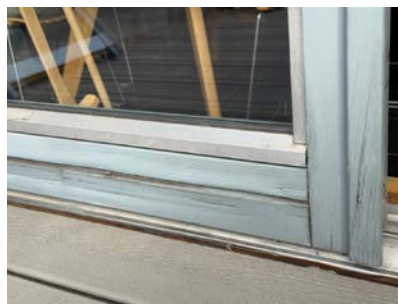
Vårslitt utvendige dører - sprekk i bunnstokk på bilde.
