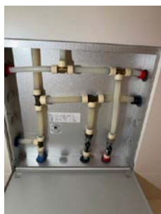
Rørskap i baderomshimling med 2 x stoppekraner.
