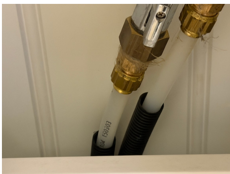
Det mangler pakning/muffe mellom innvendig – utvendig rør i rør i servantskap på toalettrom,
