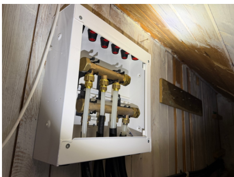
Rør i rør skap i knekott.
