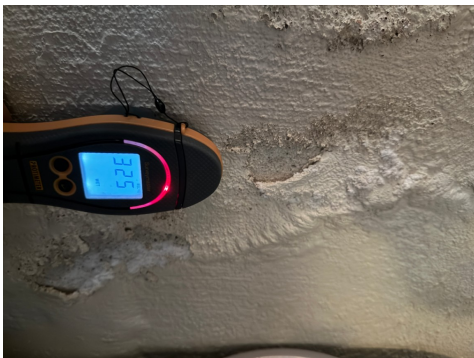
Forhøyede fuktverdier på innside av grunnmur.
