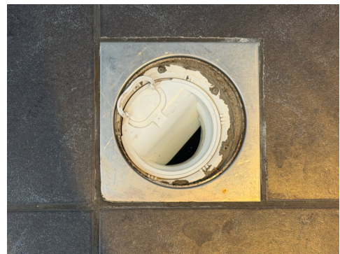
Plastsluk i dusjsone.
