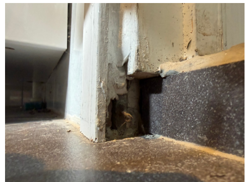
Ingen membranoppbrett v/ døråpning.
