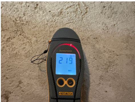
Forhøyede fuktverdier i betonggulv.
