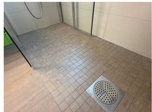
Sluk er plassert utenfor dusjsone (ukurant løsning), men dusjvann ledes til sluk.
