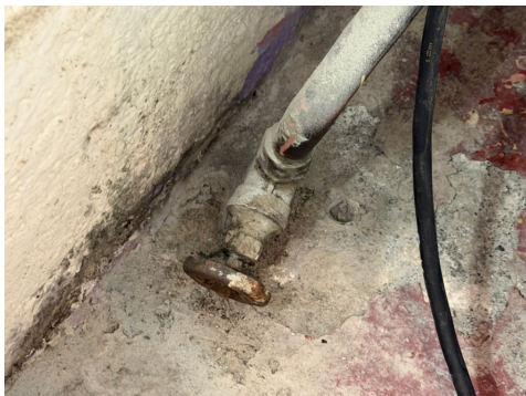
Stoppekran i u-etg.
