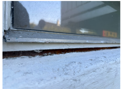
Manglende utvendig tetting/avslutning rundt vinduer i u-etg
