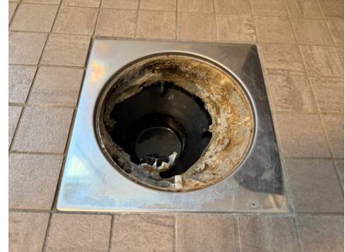
Plastsluk i dusjsone.
