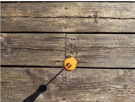
Lokal råte i terrassebord.
