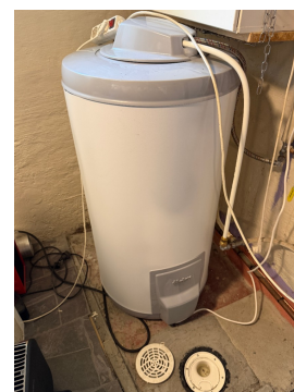
Varmtvannstank i u-etg. Det er sluk v/ varmtvannstank.
