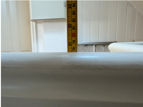
Rekkverkshøyde er under 90 cm. Avvik registrert i HMS punkt.
