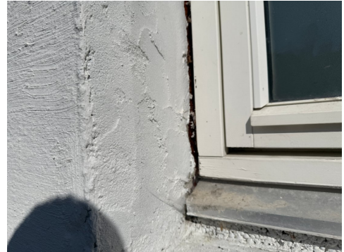
Manglende utvendig tetting/avslutning rundt vinduer i u-etg
