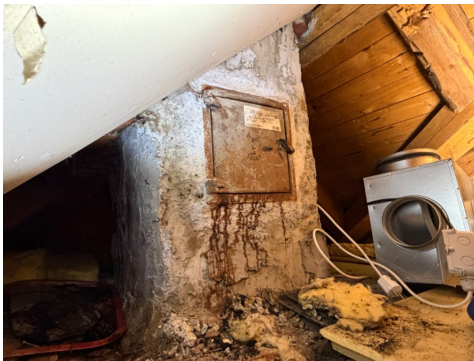
Rennemerker på pipe på koffertloft. Ingen tegn til aktiv lekkasje.
