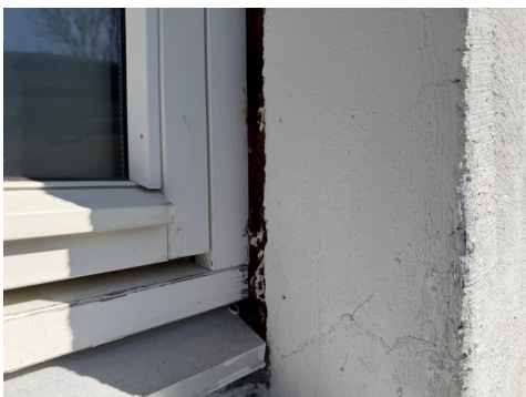
Manglende utvendig tetting/avslutning rundt vinduer i u-etg
