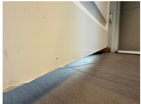
Fuktutsvelling/slitasje i nedre del av badedør.
