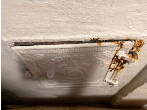
Rust på sotluke i u-etg.
