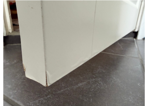
Fuktutsvelling/slitasje i nedre del av badedør.
