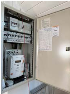
Sikringskap i gang/trapperom i loft-etg.
