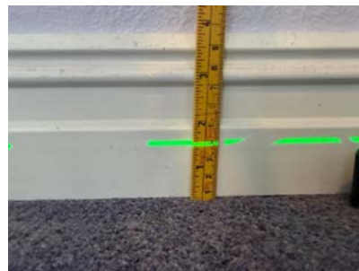
Bilder viser skjevheter i gulv på soverom 2 i loft-etg.
