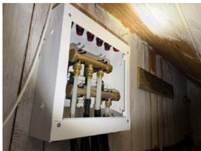
Rør i rør skap i knekott.
