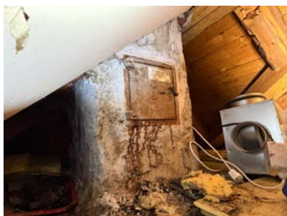
Rennemerker på pipe på koffertloft. Ingen tegn til aktiv lekkasje.
