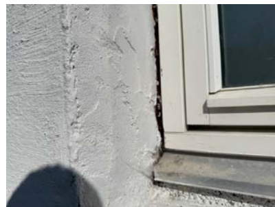
Manglende utvendig tetting/avslutning rundt vinduer i u-etg
