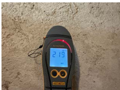
Forhøyede fuktverdier i betonggulv.
