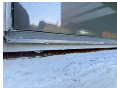
Manglende utvendig tetting/avslutning rundt vinduer i u-etg
