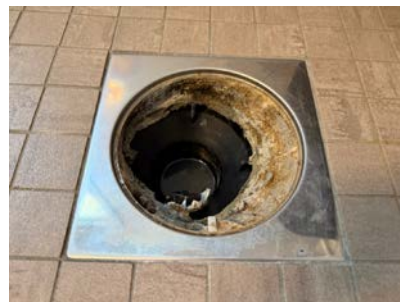
Plastsluk i dusjsone.
