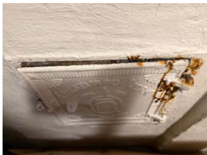
Rust på sotluke i u-etg.
