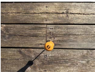
Lokal råte i terrassebord.
