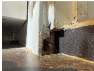
Ingen membranoppbrett v/ døråpning.
