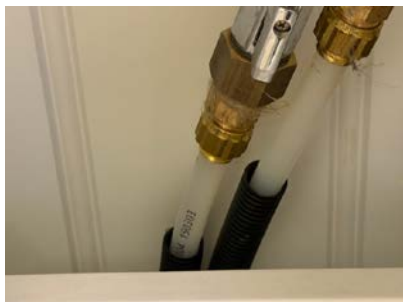
Det mangler pakning/muffe mellom innvendig – utvendig rør i rør i servantskap på toalettrom,
