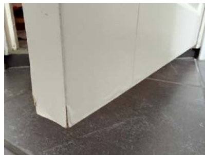
Fuktutsvelling/slitasje i nedre del av badedør.
