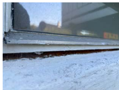
Manglende utvendig tetting/avslutning rundt vinduer i u-etg
