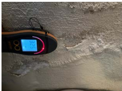
Forhøyede fuktverdier på innside av grunnmur.
