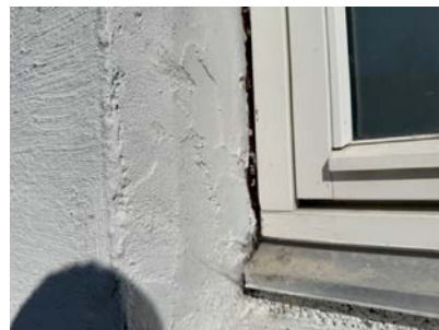
Manglende utvendig tetting/avslutning rundt vinduer i u-etg
