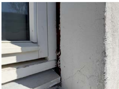
Manglende utvendig tetting/avslutning rundt vinduer i u-etg
