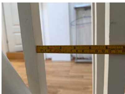
Åpninger i rekkverk er større enn 10 cm. Avvik registrert i HMS punkt.
