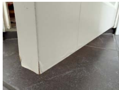
Fuktutsvelling/slitasje i nedre del av badedør.
