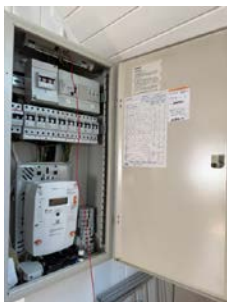
Sikringskap i gang/trapperom i loft-etg.
