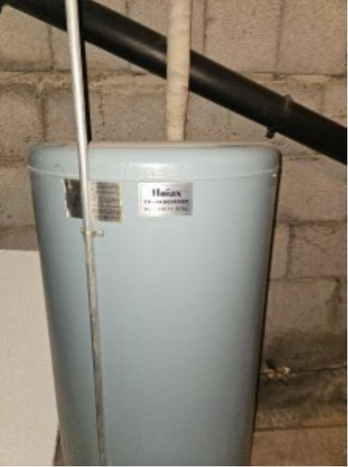
Ingen 10.3 Vannbåren varme
