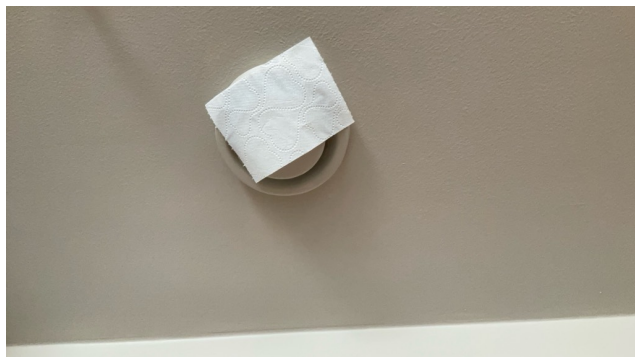
Test av avtrekksventil på kjøkkenet.
