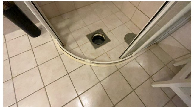
Tilrenning til sluk gjennom dusjrammen bør opparbeides.
