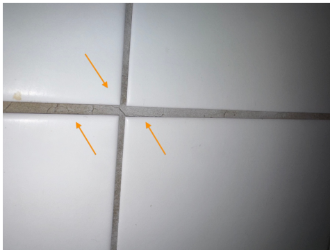
Riss i veggfliser.
