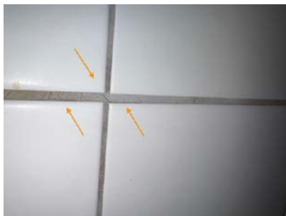
Riss i veggfliser.
