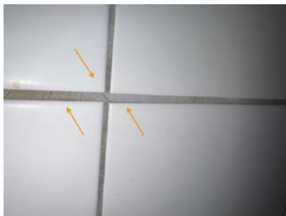
Riss i veggfliser.
